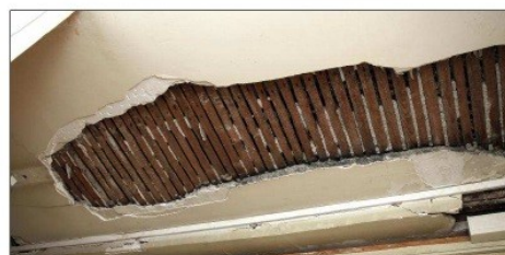
A certains endroits, les plafonds s'effondrent.
